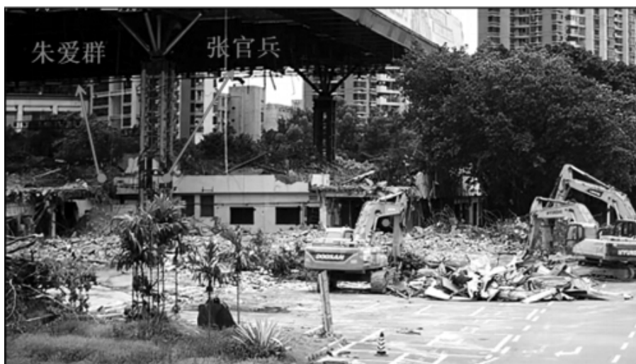
图 15 7 月 8 日 11:28:33, 西南侧发生坍塌时人员所在位置
