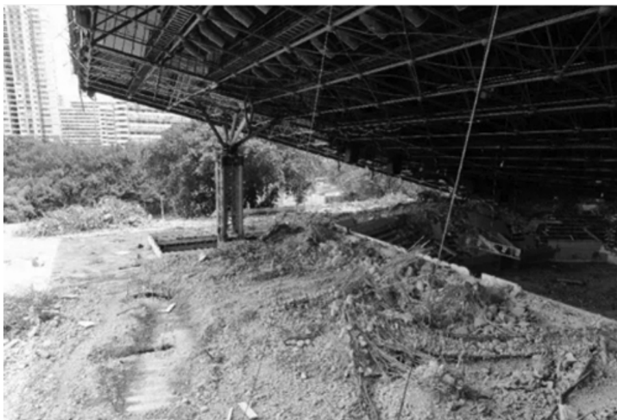
图 18 体育馆坍塌后东侧现状
