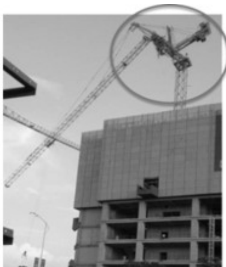
图 2-2 塔吊倾覆过程中结构宏观图
