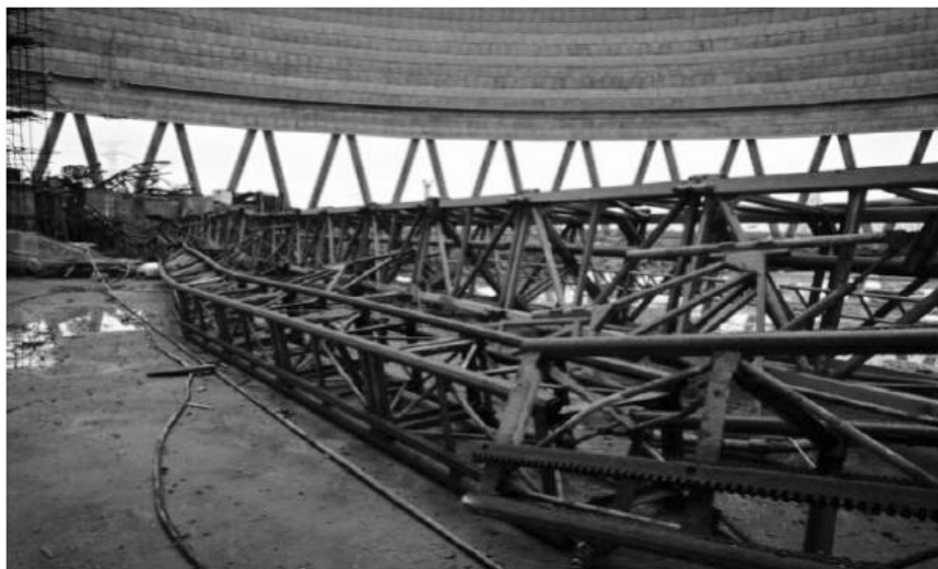
图6 事故现场坍塌平桥
