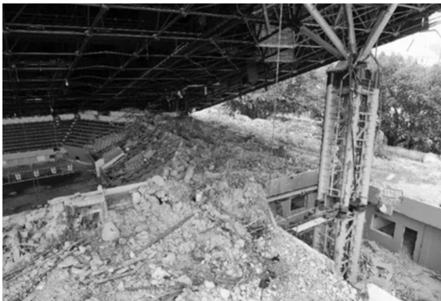
图 19 坍塌后屋架下现状
